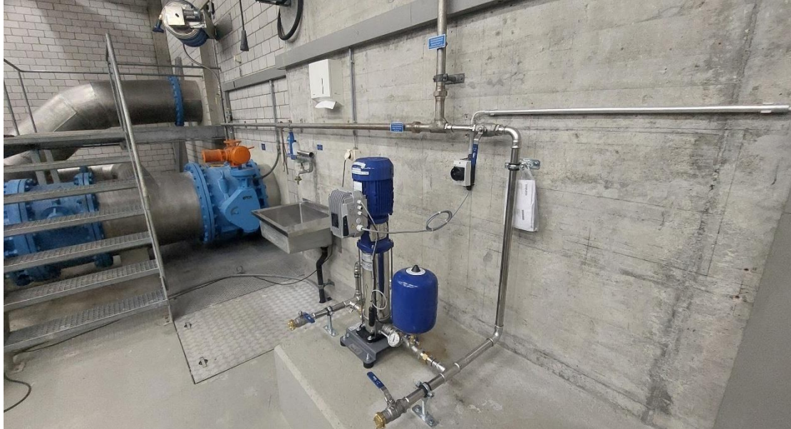
Abbildung 5: Reinigungsanlage Reservoir Müliberg
