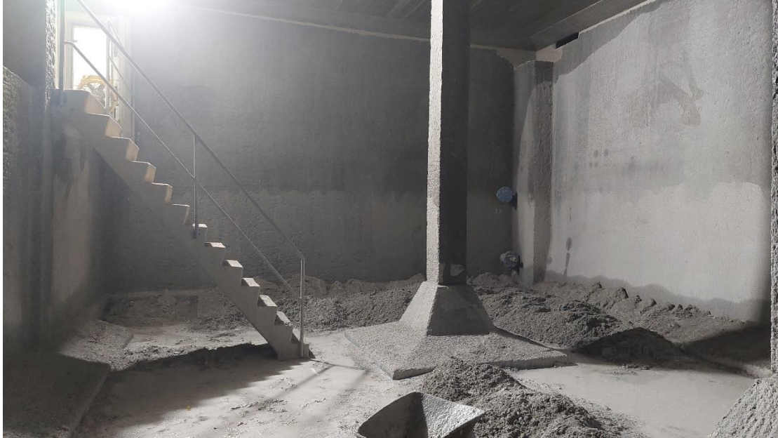
Abbildung 3: Beschichtungsabtrag in der Kammer 2
