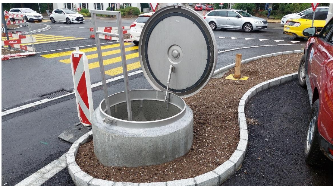
Abbildung 11: Neuer Messschacht Dorfstrasse
