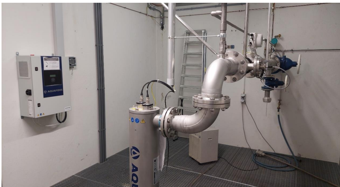
Abbildung 6: UV-Anlage Pumpwerk Einfang
