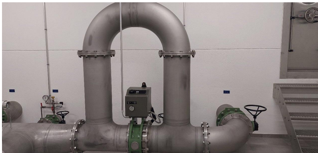
Abbildung 1: Bogen mit elektrischer Klappe für die Löschwasserreserve
