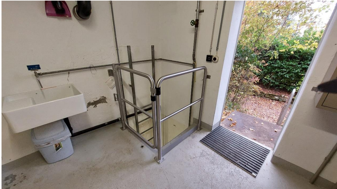
Abbildung 3: Absturzsicherung Reservoir Geisshügel
